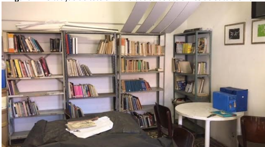
Figura 2 – Situação do teto em uma das salas até o mês de outubro 2021
