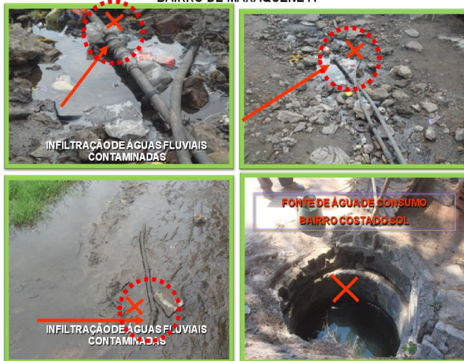
Foto 5- Casos de ligações clandestinas executadas pela população carente sobre a rede oficial de distribuição de água. As ligações são precárias e feitas com canos velhos e furados e na emenda, plásticos fazem a fixação. Nota-se também, uma cacimba de água situada ao lado das latrinas.
